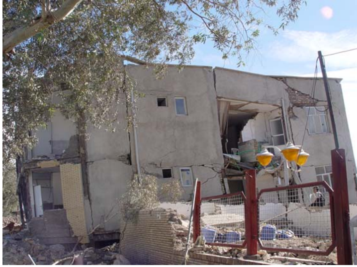
جهت تغییر شکل موازی با گسل، شمال شرقی - جنوب غربی
