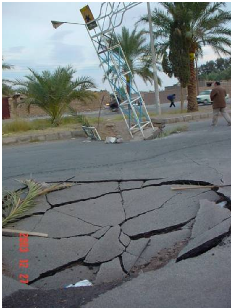
شکل (۲-۲۳): فروچاله ایجاد شده در بروات در نزدیکی افتگاه گسله بم و بر مسیر قنات های بروات
