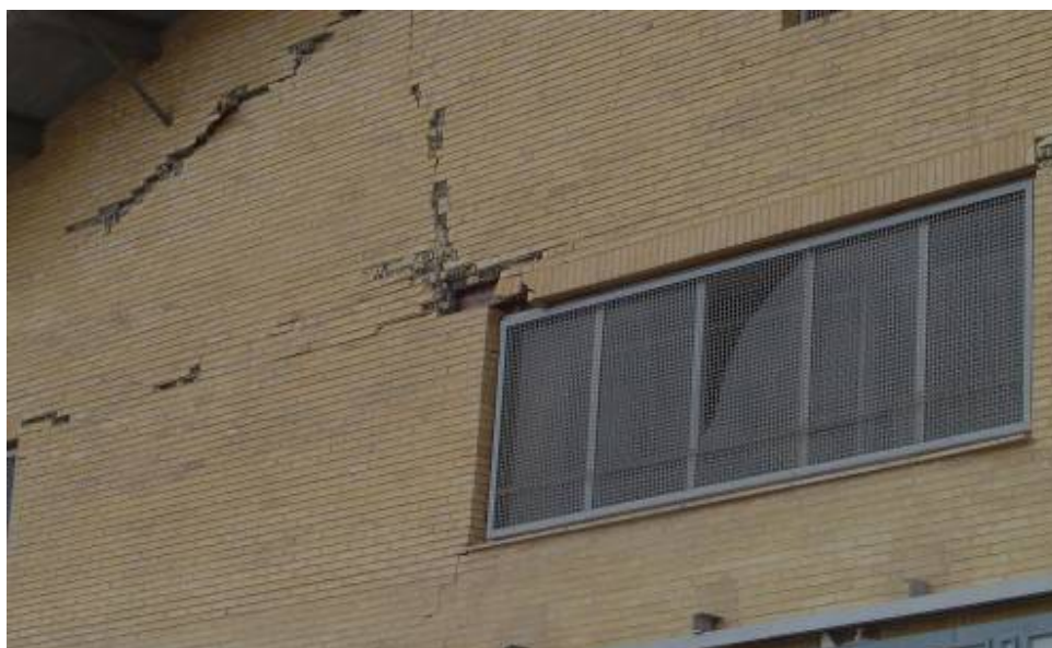
شکل (۹-۳): ترک خوردگی دیوار و ریزش بخشهایی از نما در یک ساختمان متعلق به هلال احمر
