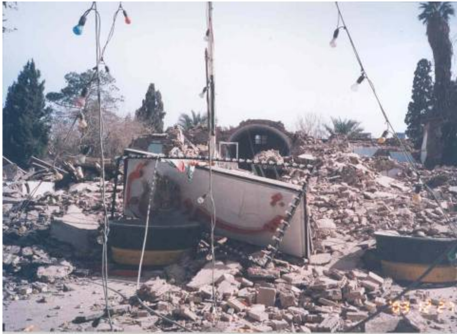
شکل (۳-۱۰): تخریب کامل ساختمان شهرداری بم
