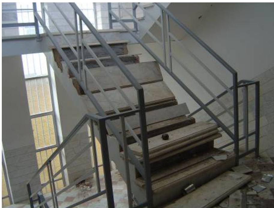
شکل (۸-۳): خسارت ناسازه ای در ساختمان هلال احمر
