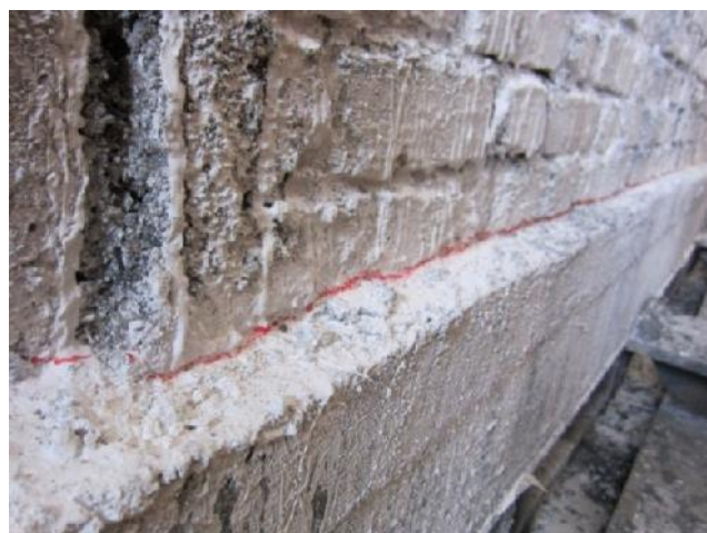
شکل ۶: اولین ترک در محل اتصال فونداسیون و دیوار
