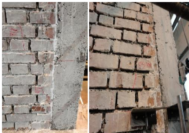
شکل ۱۳: ترک‌های اولیه در دیوار
