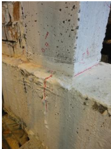
شکل ۱۲: ترک در مرز کلاف و فونداسیون
