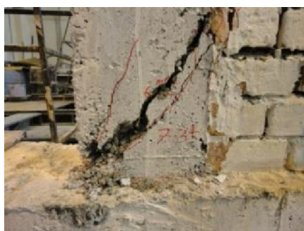
شکل ۱۶: خردشدگی پای کلاف قائم
