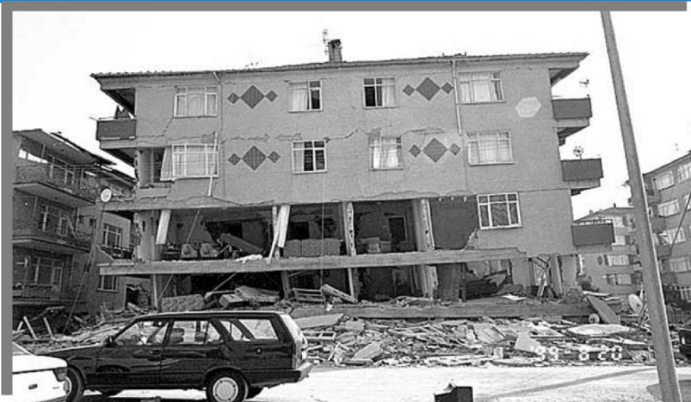
شکل ۳ - از دست رفتن کامل دو طبقه اول از یک ساختمان شش طبقه قاب خمشی بتنی (Sezen et al., 2002)
